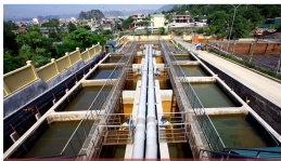
TRẠM XỬ LÝ NƯỚC THẢI XÃ NGUYỄN HỮU - HUYỆN BỐNH TRIỀU - QUẢNG NINH
